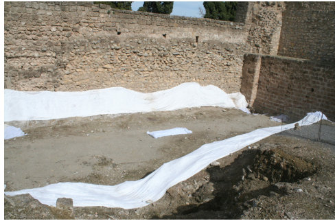
Castillo. Reposición de geotextil en el sector NW.
